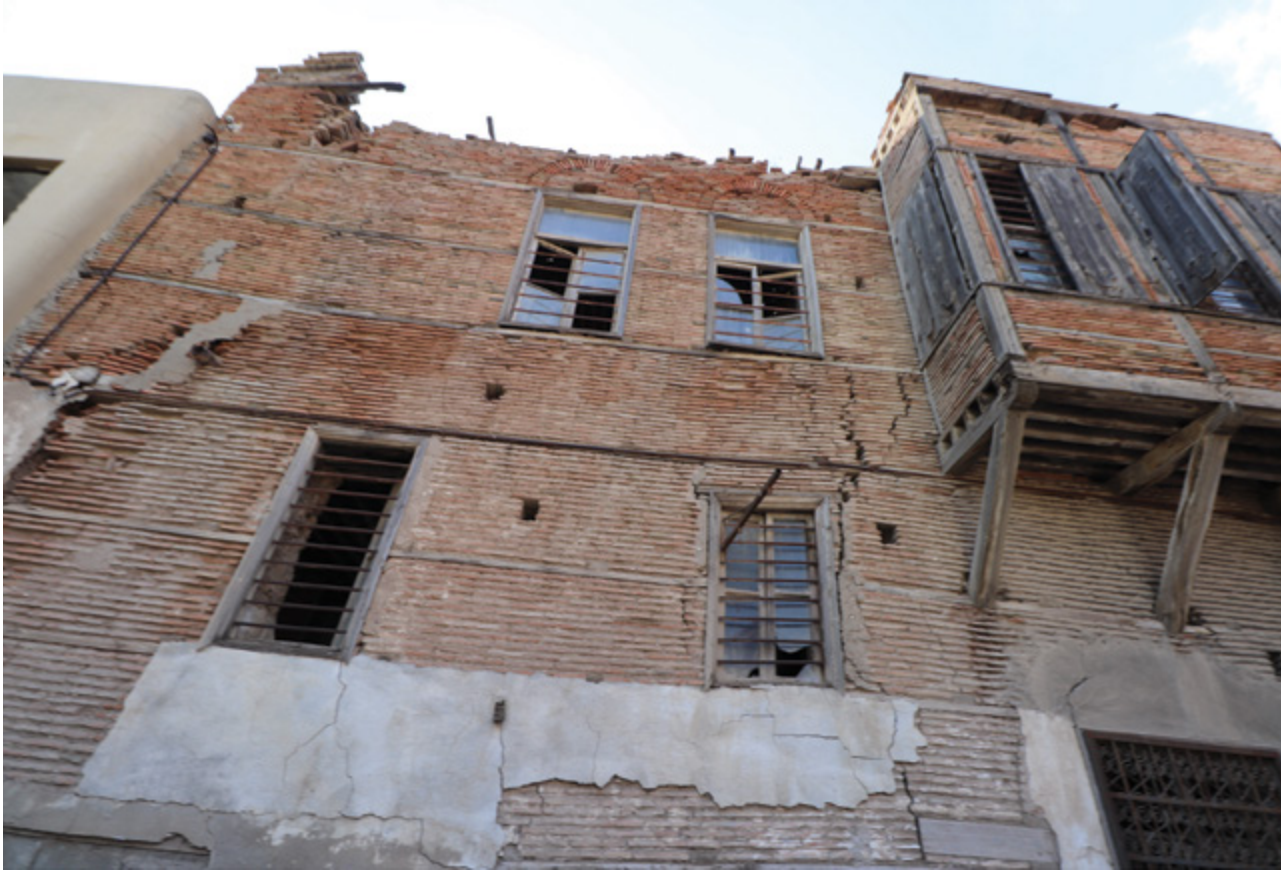
Şekil 8. SEY-7 yapısında görülen hasarlar.
