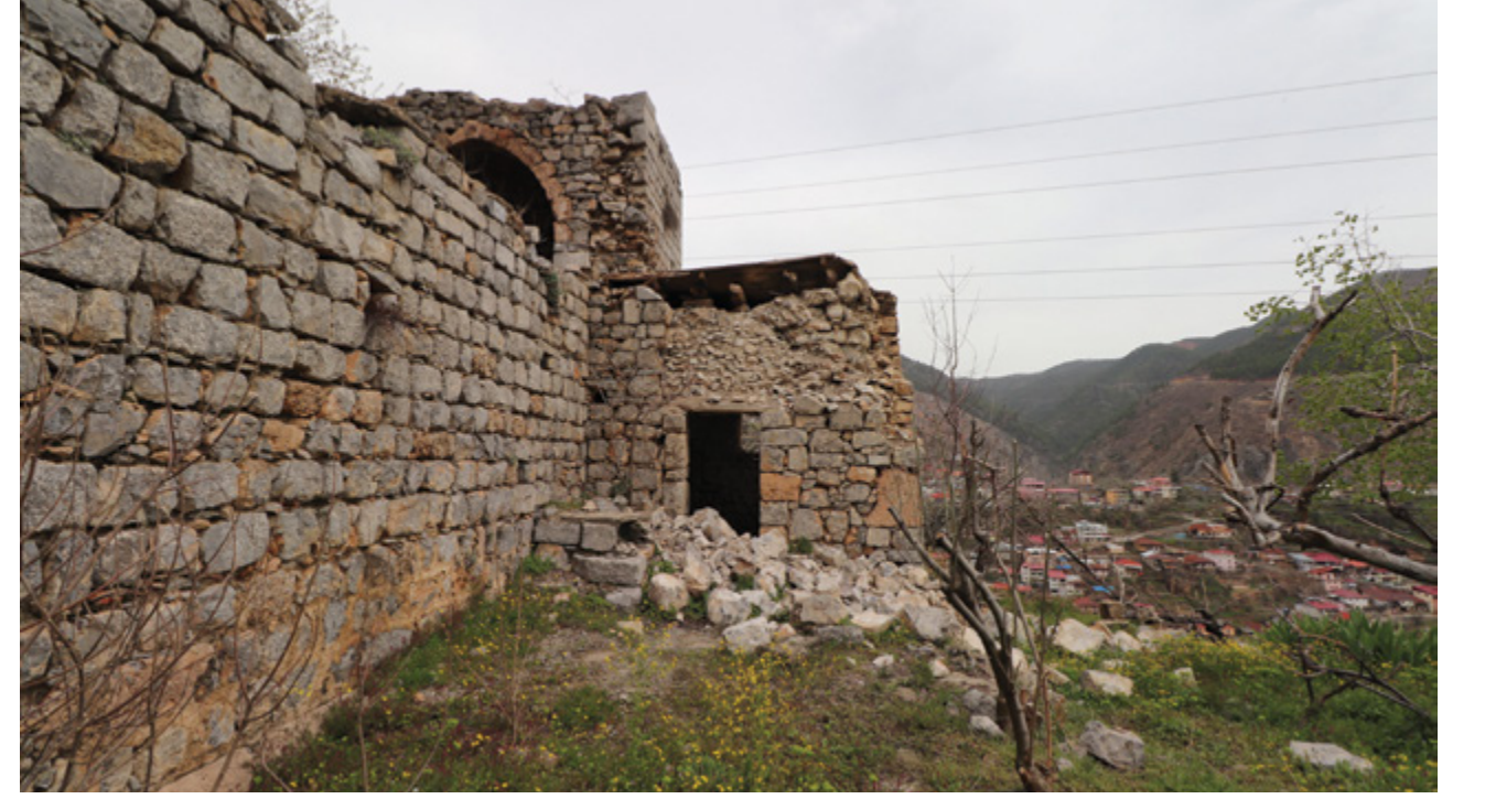
Şekil 3. Surp Hagop (St James) Manastırı'nda deprem kaynaklı hasarlar, 2023.
