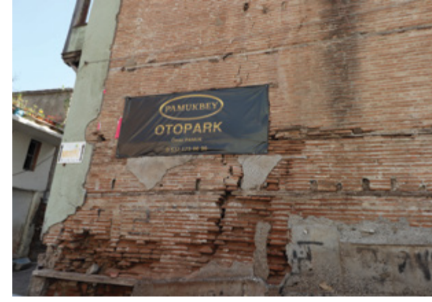
Şekil 10. SEY-22 yapısında görülen hasarlar.
