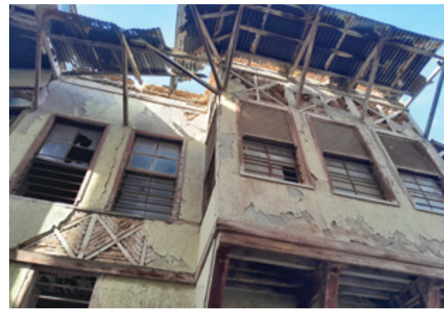
Şekil 6. SEY-4 yapısında malzeme kayıpları ve yapısal hasarlar.
