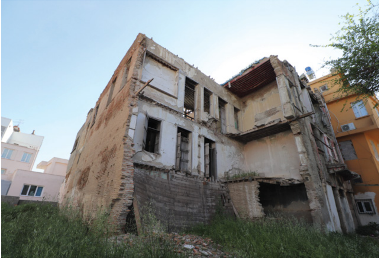
Şekil 9. Ağır hasarlı SEY-11 yapısı (yapıdaki mekânsal/yapısal kayıplar Şubat 2023 Depremi ile ilişkili değildir).
